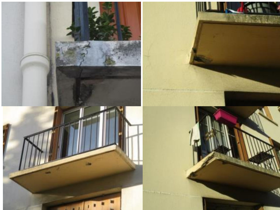
Défauts de scellement des garde-corps, éclatement des bétons, corrosion des armatures
