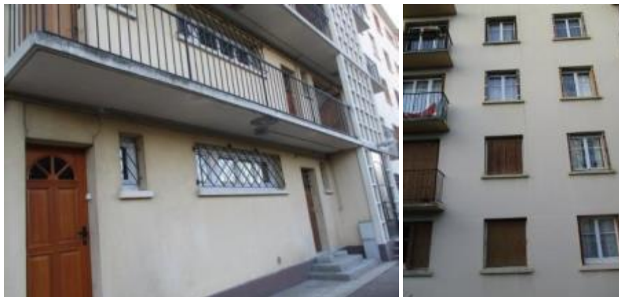
Salissures liées au mauvais écoulement des eaux pluviales et à l'absence d'éléments de protection
