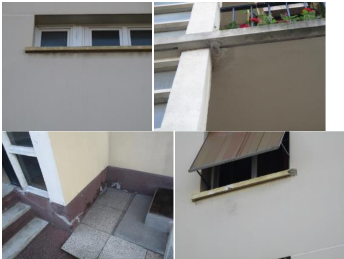
Fissures diverses observées de manière régulière
