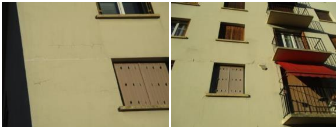
Fissuration et écaillage du revêtement
