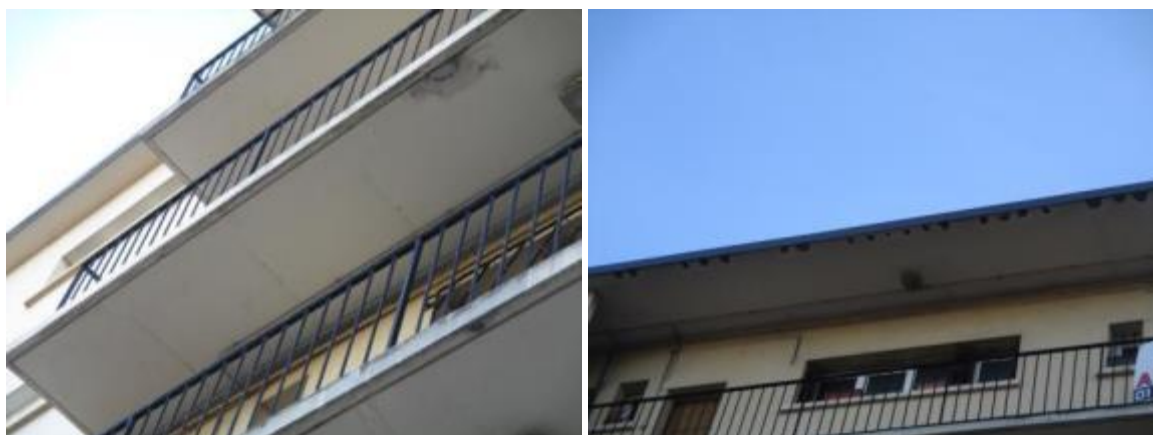
Eclatements probablement liés à des infiltrations
