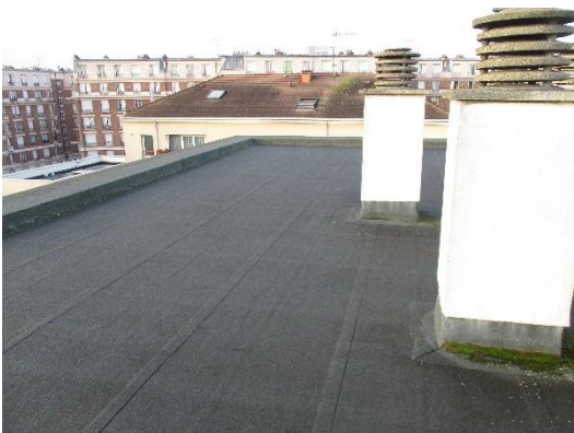
Mise en sécurité non conforme
